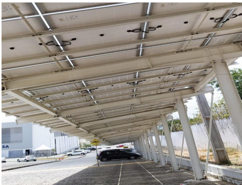
Figura 26 - Estacionamento com cobertura em painéis solares da Unifacisa - Campina Grande-PB
