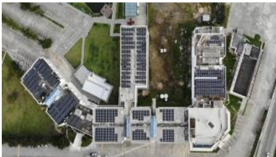
Figura 25 - Vista aérea de um sistema fotovoltaico instalado sobre a estrutura predial do Centro Universitário – UNIFACISA em Campina Grande-PB
