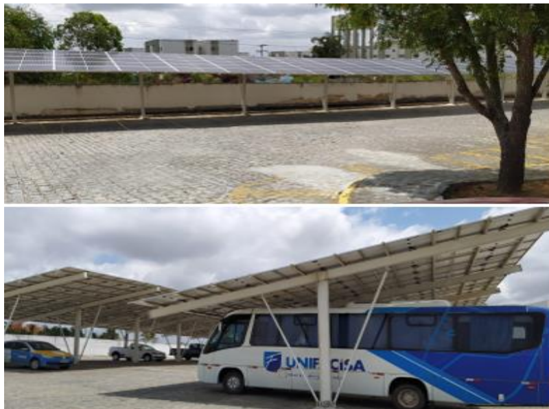
Figura 27 - Estacionamentos com cobertura em painéis solares da Unifacisa - Campina Grande-PB
