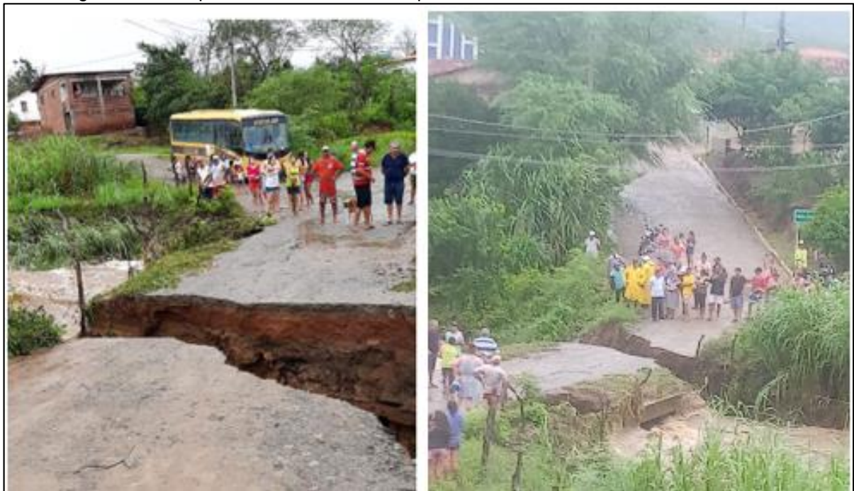
Figura 36 - Rompimento de acesso local após cheia do Riacho dos Grossos na Jurema
