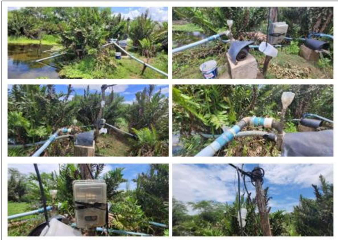
Figura 20 - Sistema de captação fluvial no Juá
