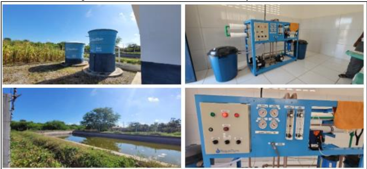
Figura 30 – Estrutura do Sistema de Dessalinização do PAD
