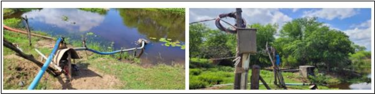
Figura 33 - Sistema de captação fluvial nas residências da Jurema
