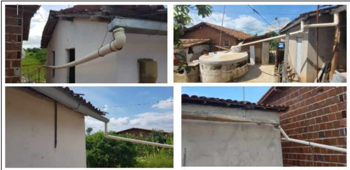
Figura 32 - Sistema de captação pluvial nas residências da Jurema
