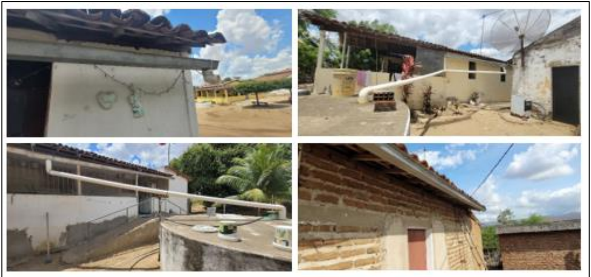
Figura 19 - Sistema de captação pluvial nas residências do Juá
