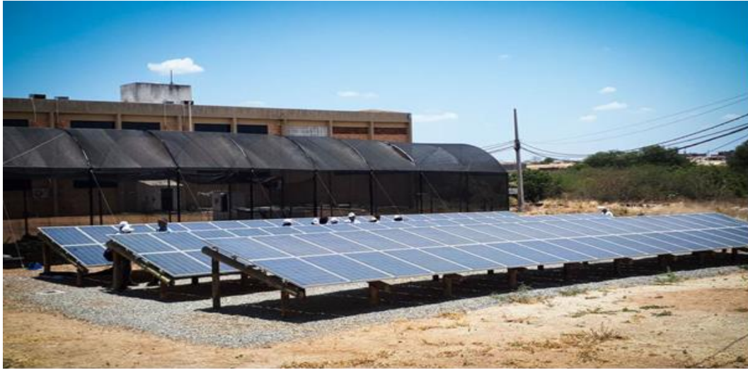
Figura 29. Sistema fotovoltaico instalado na Universidade Federal de Campina Grande, campus Pombal, Pombal, PB.
