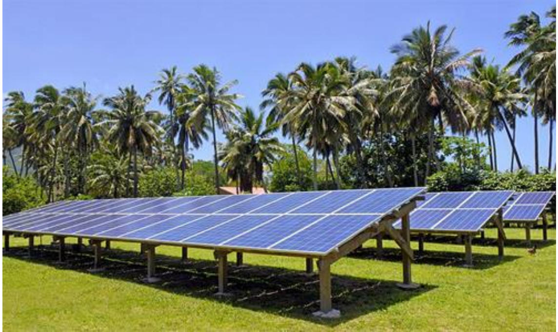
Figura 4. Vista de painéis fotovoltaicos
