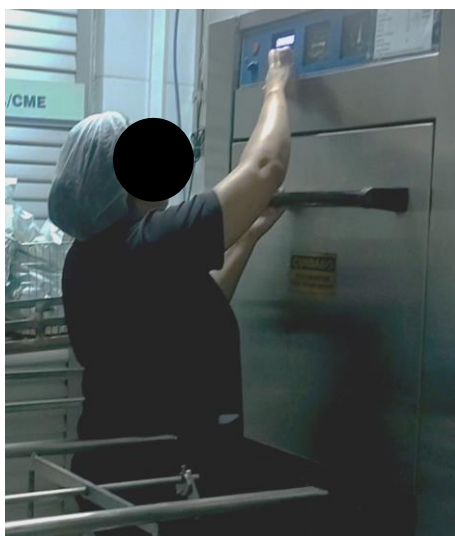
Figura 12 - Posicionamento elevado do painel de controle de uma autoclave na CME do hospital de emergência e trauma, Campina Grande, PB, 2024.
