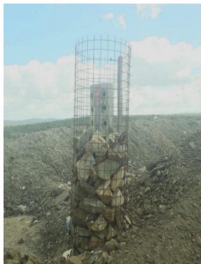
Figura 15 – Dreno de gases vertical no aterro sanitário utilizado na pesquisa
