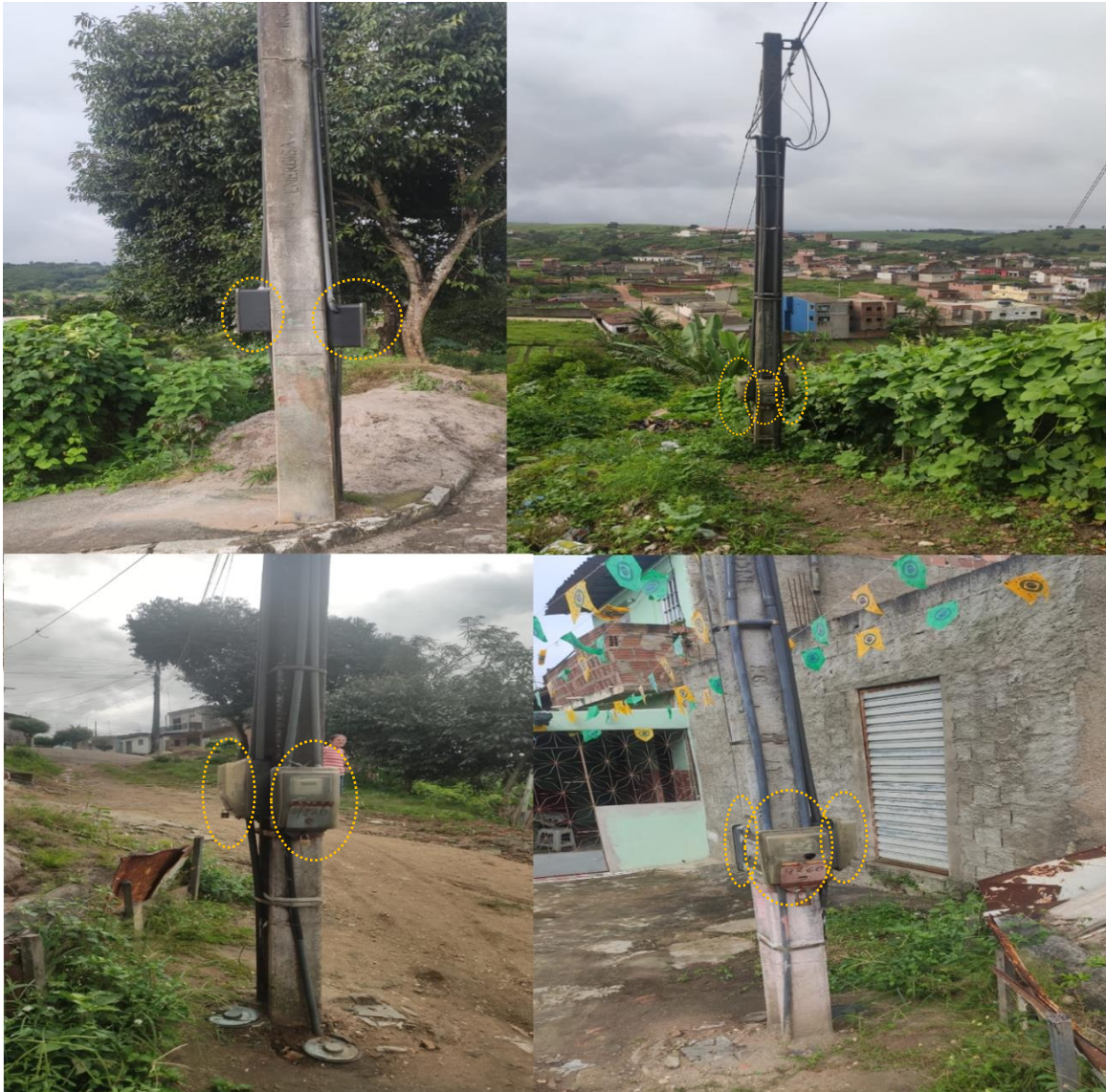
Figura 5 – Caixas de energia elétrica responsável pela ligação dos poços coletivos
