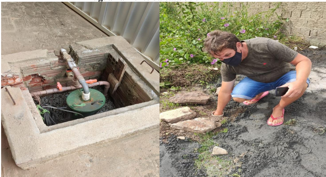
Figura 7 – Poços perfurados por Neto e o desligando uma das torneiras de passagem de água na frente da casa de um morador
