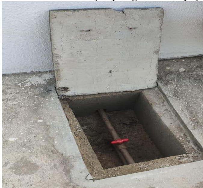
Figura 11 – Sistema de tubulação que liga a casa ao poço privado
