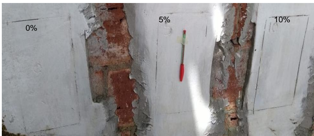
Figura 12 - Imagem do dia 06/05/2020 do reboco realizado em 08/12/2018 com 0%, 5% e 10% de RIG.
