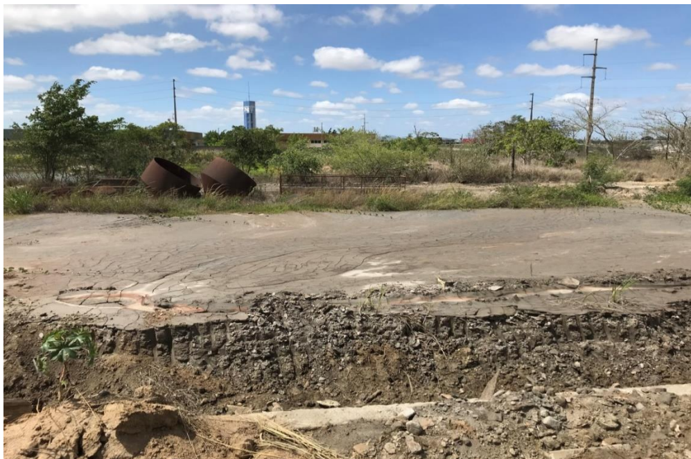
Figura 3 – Disposição final incorreta do resíduo industrial de granito
