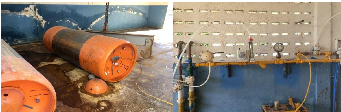
Figura 10 - Bombas de Controle de Distribuição do Cloro.
