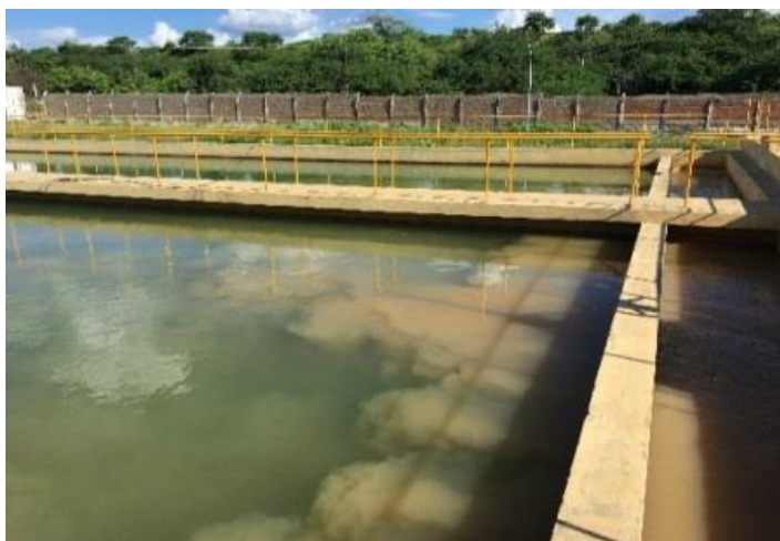
Figura 08 - Decantador de Grande Porte.
