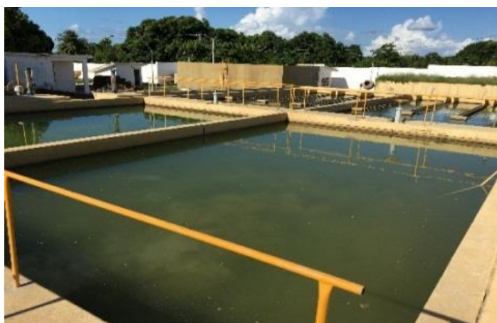
Figura 07 - Decantador de Médio Porte.
