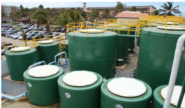
Figura 9: Estação de tratamento de esgoto do complexo Beach Park.
