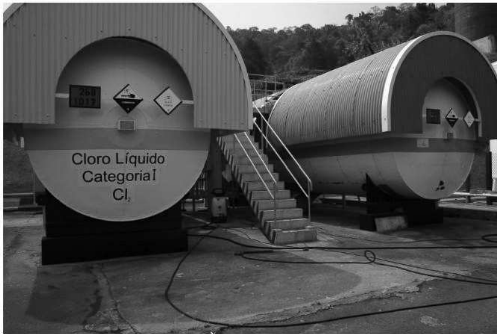
Tanques com cloro e outros produtos químicos usados para tornar a água potável
