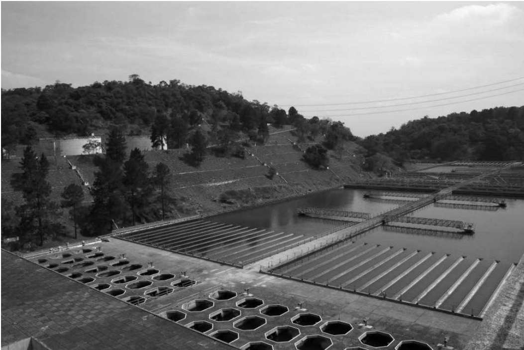
Tanques usados nas quatro fases do processo de tratamento de água da Estação do Guarapiranga, em São Paulo
