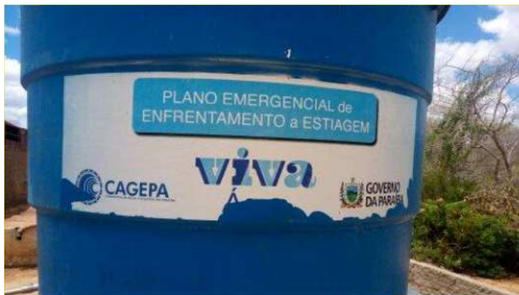
Figura 16 – Caixa d'água de armazenamento de águas subterrâneas
