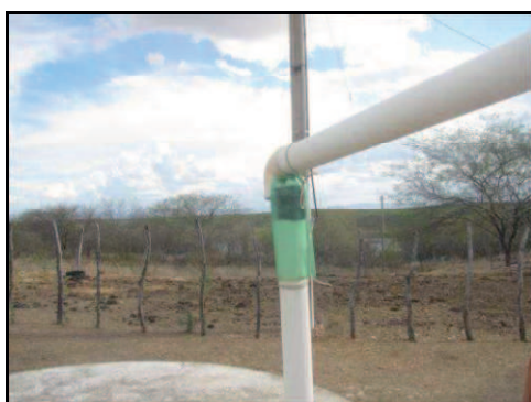
Figura 06: Sistema de calha que leva a água do telhado para dentro da cisterna. Foto: Janeiro, 2012
