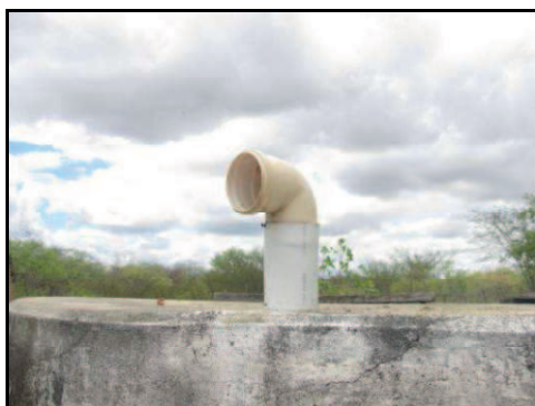
Figura 14: Encanação sem vedação ou proteção. Foto: Janeiro, 2012
