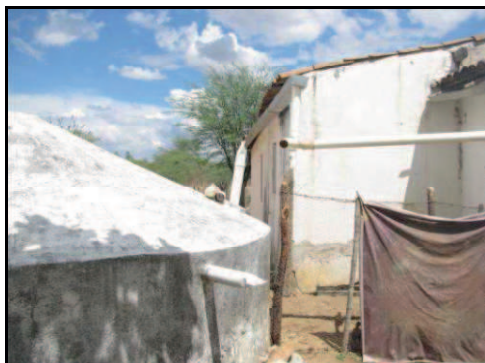
Figura 12: Ductos de captação desconectados. Foto: Janeiro, 2012
