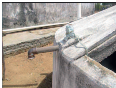
Figura 11: Bomba danificada. Foto: Janeiro, 2012
