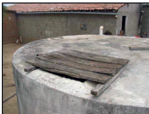
Figura 15: Porta improvisada sem o fechamento adequado. Foto: Janeiro, 2012
