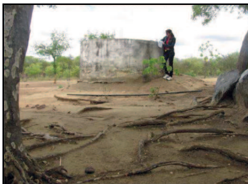
Figura 03: Cisterna implantada próximo à raízes de árvores. Foto: Janeiro, 2012
