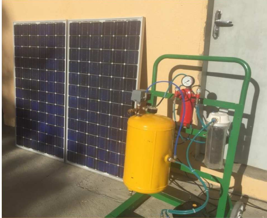
Figura 16 – Sistema fotovoltaico para acionamento do Compressor.
