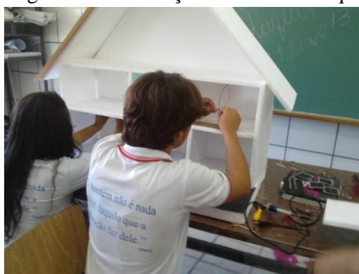
Fotografia 6 - Instalação elétrica da maquete
