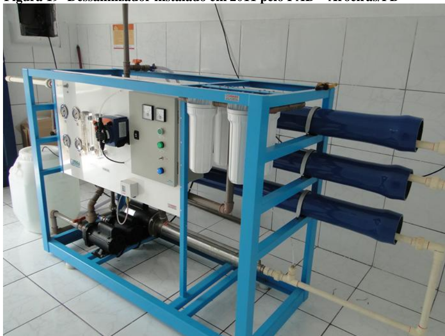
Figura 19- Dessalinizador instalado em 2011 pelo PAD – Aroeiras/PB
